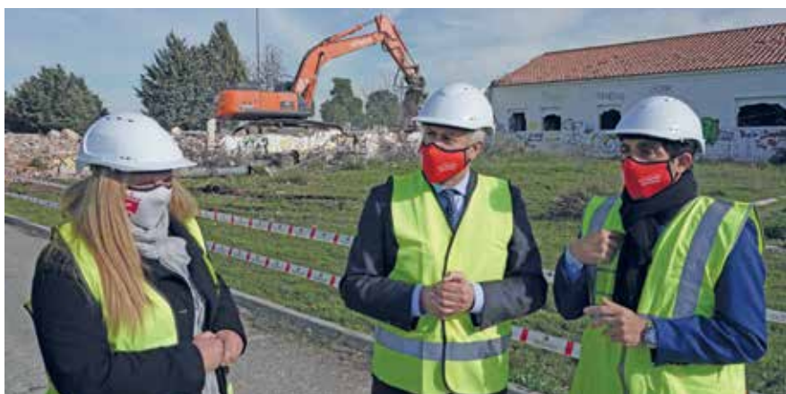
▲ El alcalde y el vicealcalde, al pie de las estructuras que se están empezando a demoler.
